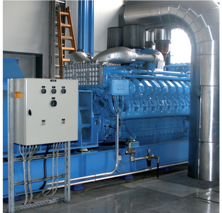
Notstromversorgung eines Unternehmens, Vier MAN-Dieselmotoren werden bei Stromausfall mit Druckluft gestartet und können die wichtigsten Bereiche mit Strom versorgen
