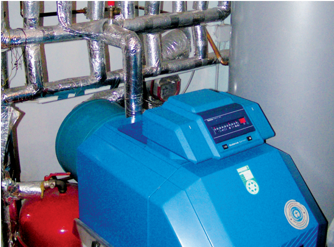
Moderne Heizungsanlagen sind sehr effizient aber auch stromabhängig
