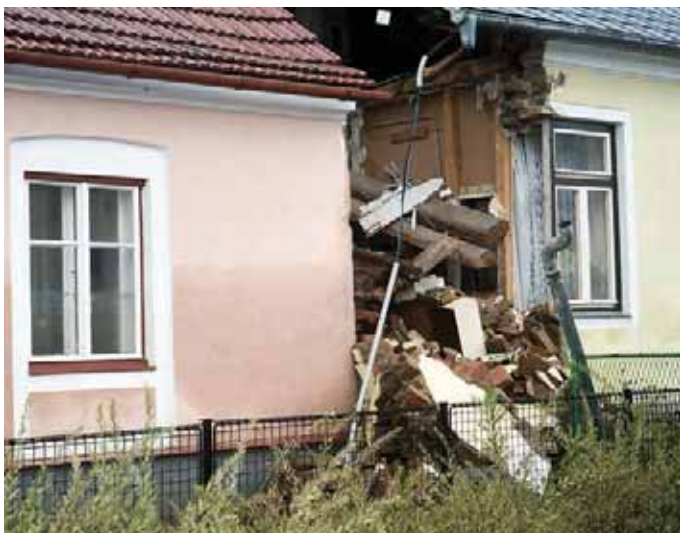
Gebäudeschaden durch Hochwassereinwirkung Hadersdorf am Kamp, Hochwasser 2002
