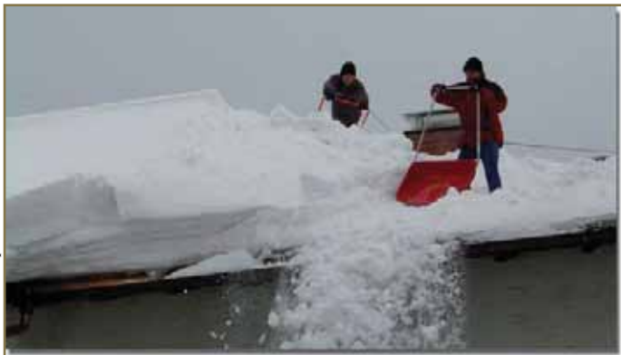
Wer sein Dach trotz großer Schneemassen nicht abschaufelt, kann im Schadensfall den Versicherungsschutz verlieren. Es würde die Sorgfaltspflicht verletzt.
