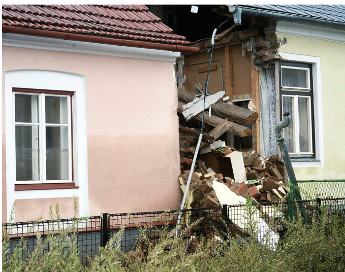
Gebäudeschaden durch Hochwassereinwirkung Hadersdorf am Kamp, Hochwasser 2002
